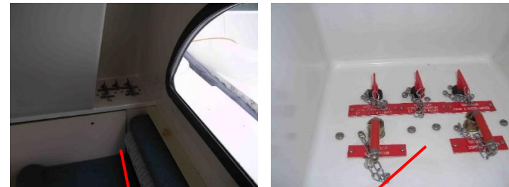
Coupe-circuits / master switches / Batterie Hauptschalter
